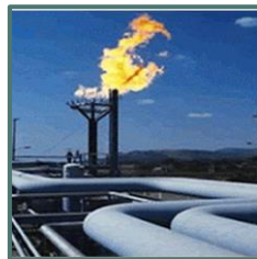
Jaringan pipa migas
